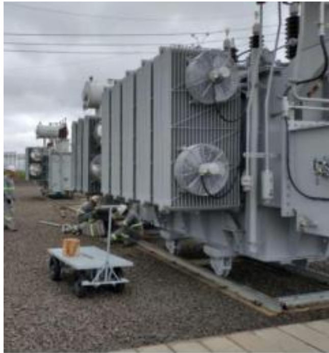
Figura 5 - Inspeção TR5 Subestação
